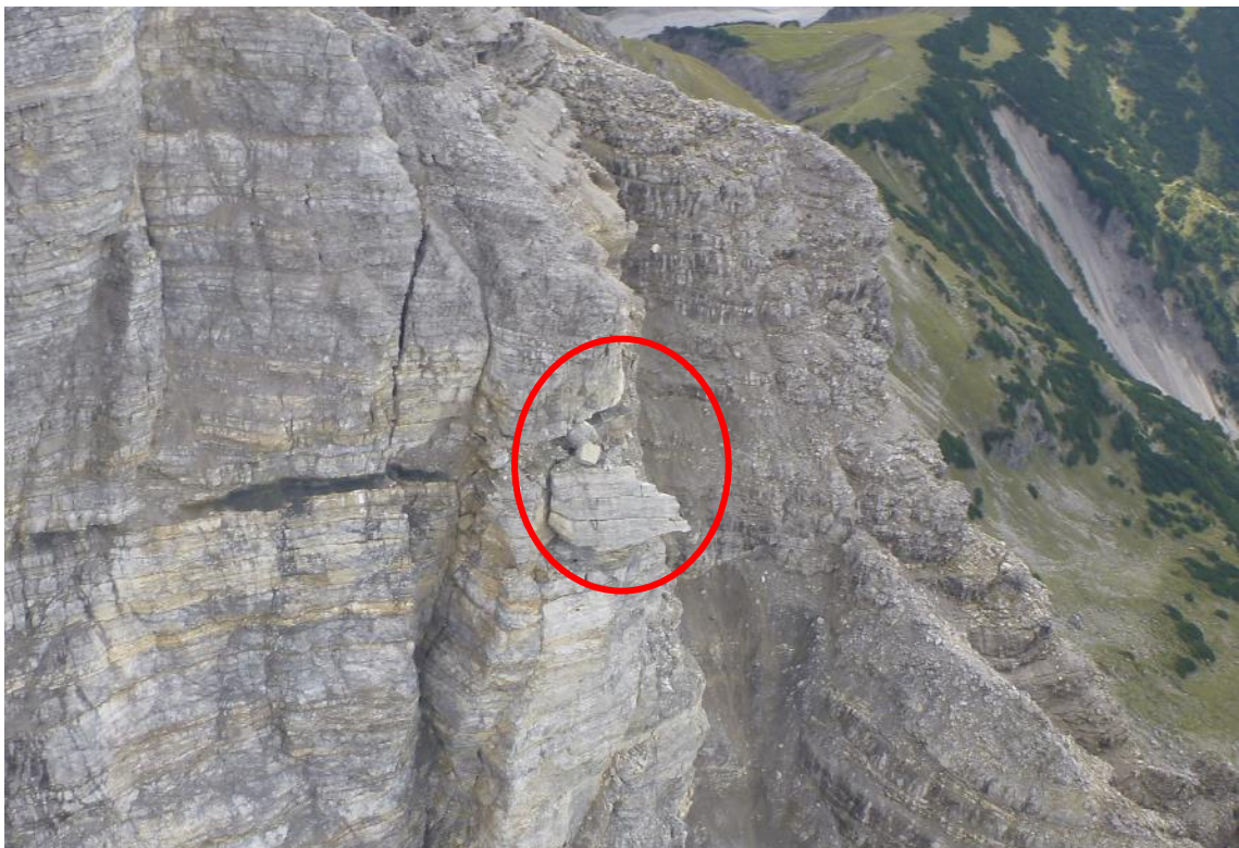
Foto 1: Mit roter Ellipse markiert die markante Felsnase in der Westflanke. Oberhalb derselben kam es zu erkennbaren Abbrüchen.
